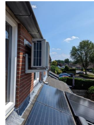
Foto 6: Airco buitenunit aan de gevel.
