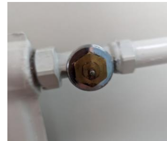
Foto 6: Niet regelbare radiatorkraan. Ongeschikt voor waterzijdig inregelen
