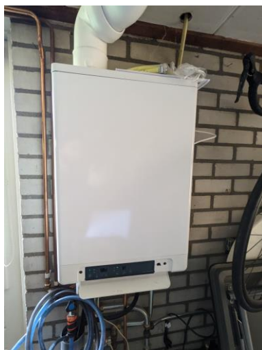
Foto 4: Huidige cv-ketel en aansluitingen
